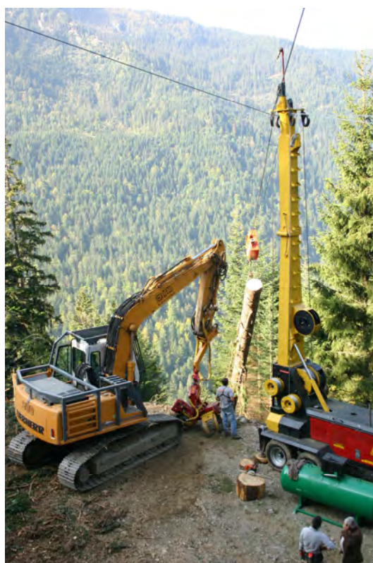
Coupe à câble sur la commune d'Arvillard.
