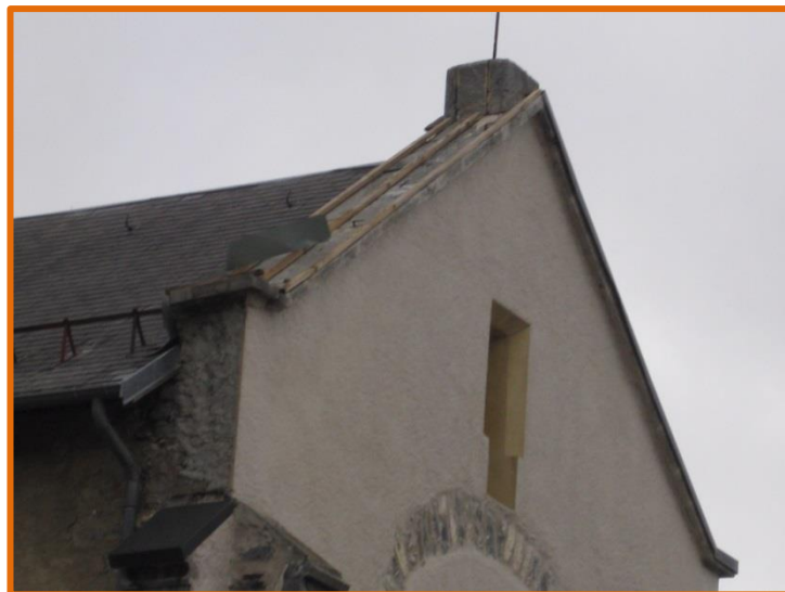
une rive de toit de l'église arrachée
