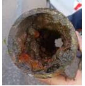
Intérieur d'une canalisation fonte
