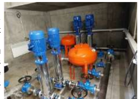
Station de pompage Pont de la Provenchère
